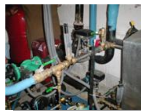
Петрозаводск Тепловой пункт
